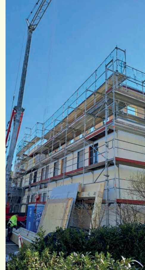
Anfang Februar: Die Konturen des neuen Stockwerks sind schon erkennbar. Der Kran befördert die vorgefertigten Holzbauteile aufs Dach.
